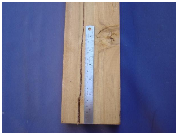
Figura 8 - Rachaduras com comprimento maiores do que 15,0 cm
